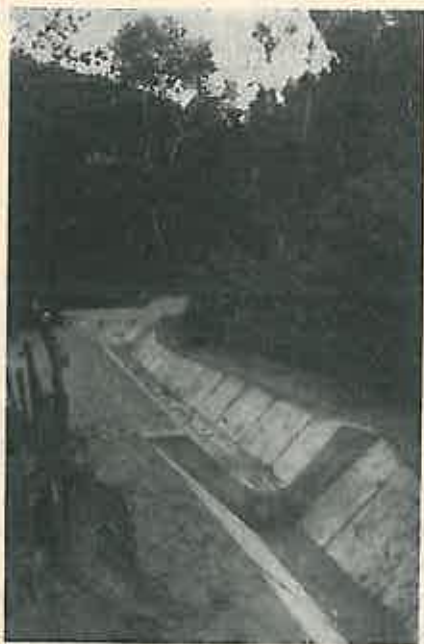
Fig. 5. Canal de scurgere construit în anul 1959, pe Valea Albului, perimetrul de ameliorare Berevoești, regiunea Pitești.
