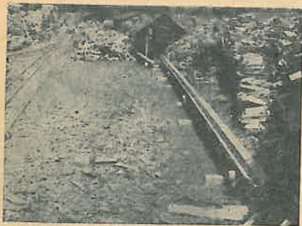
Fig. 4. Transportor instalat la despicioar mecanic.
