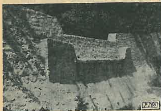
Fig. 3. Baraj de zidărie de piatră, înalt de 2,50 m, construit în anul 1953 și supraînălțat cu 1 m în 1956, pe torentul Valea cu Apă din perimetrul Bujoreni (bazinul Oltului).
