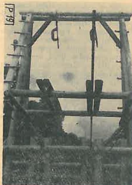
Fig. 1. Stație intermediară în construcție la parchetul Vișinul, în sectorul de exploatare Valea Lupului, I. F. Curtea de Argeș (inovație premiată la concursul pe țară al Ministerului Economiei Forestiere).
