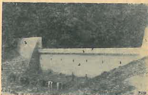
Fig. 1. Baraj din placă de beton armat în consolă, executat experimental în anul 1961 pe torențul Valea Ursului, perimetrul de ameliorare Lerești-Museel, Regiunea Argeș:
