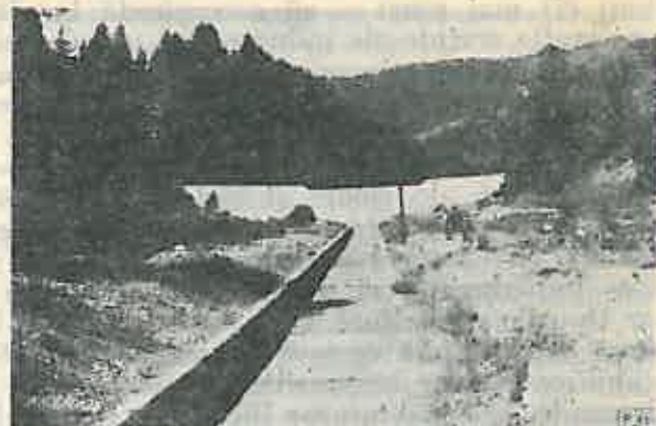
Fig. 3. Valea Bistriței - torențul Roșieni. Baraj de retenție și canalul de evacuare a apelor.
