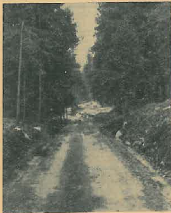
Fig. 2. Tronson de drum forestier, unde lipsa de defrișare agravează situația locală cauzată și de debleul plin.
