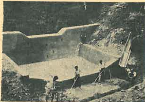
Fig. 2. Lucrări de stingere a torenților executate de Ministerul Silviculturii, Industriei Lemnului și Hârtiei în bazinul de interes hidroelectric al Argeșului — Comuna Băiculești. Construcția unui baraj de beton, cu radier și contrabaraj.
