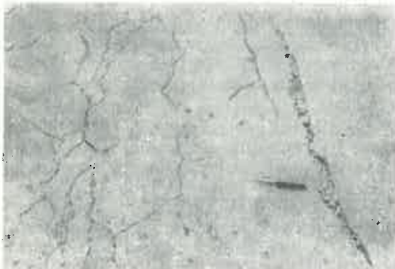
Fig. 2. Aspectul degradărilor pe D.N. 17 Vatra Dornei—Cîmpulung — km 171+400.
