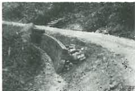
Fig. 8. Zid de sprijin din blocuri de beton simplu, prefabricate, cu goluri armate cu țevi PVC. Drum Timiș-Brașov.
