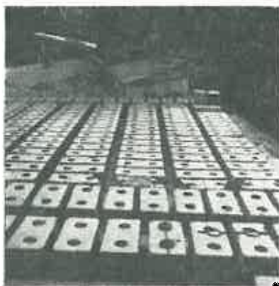
Fig. 9. Blocuri prefabricate din beton simplu cu goluri pe platforma de turnare (atelierul Săcele — Brașov).
