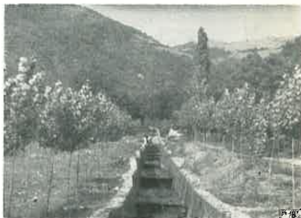
Fig. 4. Perimetrul Presaca (Valea Remeși). Canal de evacuare a apelor torențiale care, la revărsări, pricinuiă pagube gospodăriilor vecine și distrugeau șoseaua pe circa 60 m.
