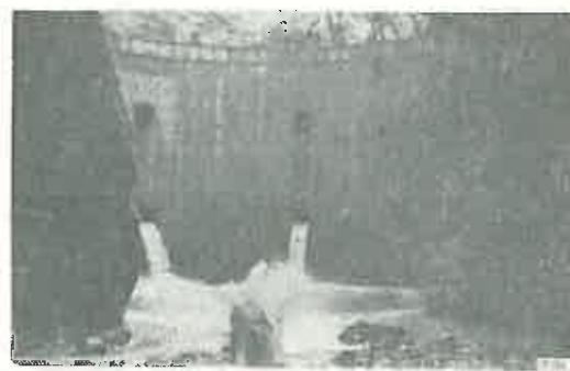
Fig. 6. Barajul de sedimentare Castelvieil, torentul „la Pique“ (Luchon-Haute Garonne-Pyrenées Centrales). Lucrări în curs de execuție.
