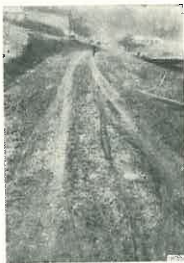
Fig. 3. Aspect al drumului după distrugerea tratamentului superficial simplu.
