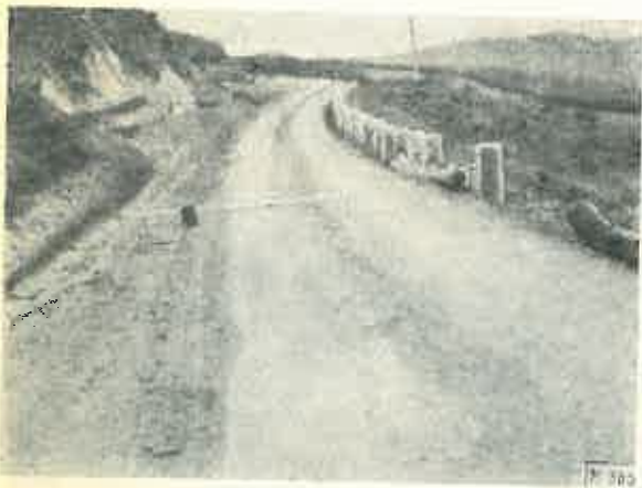
Fig. 6. Deformații cu rupturi marginale ale sistemului rutier.
