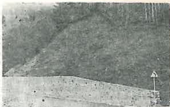
Fig. 2. Taluz debleu (Stațiunea 1 b) pe drumul transfăgărășan. Vedere din anul 1973.
